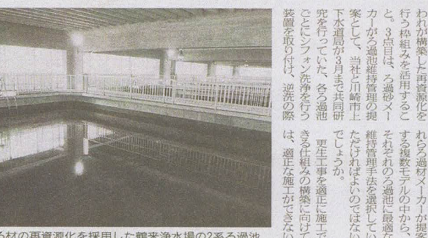
ろ材の再資源化を採用した鶴来浄水場の2系ろ過池
